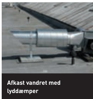
Ventilator på køleanlæg (inkl. støjskærm) samt luftindtag mod nord
