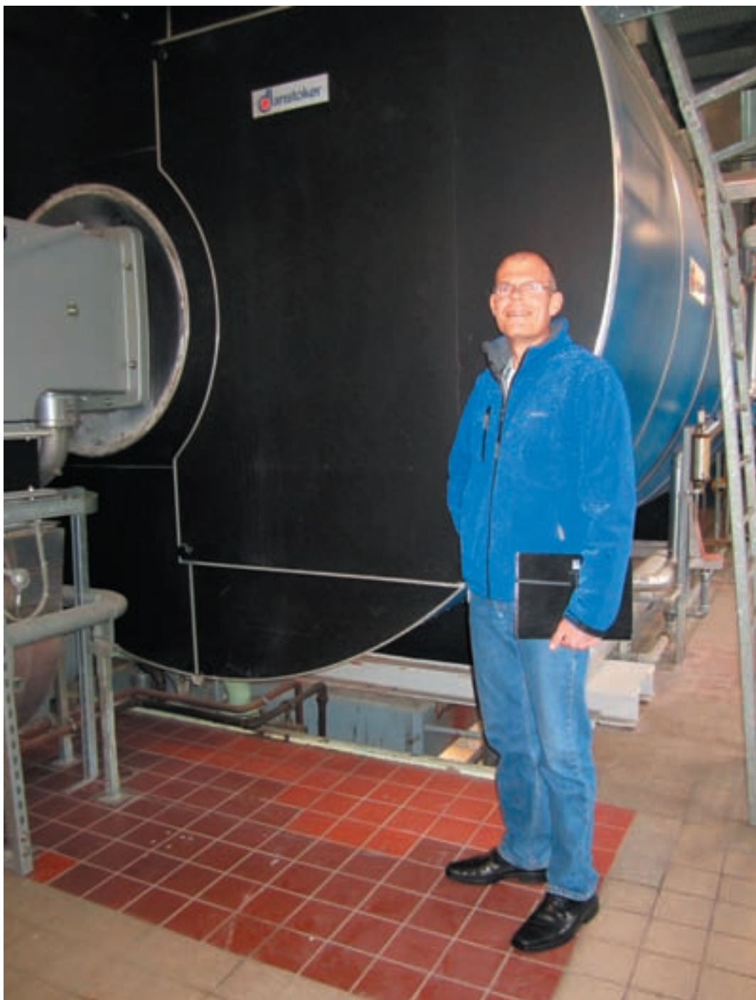
Svend Thygesen er Energiingeniør hos Leo Pharma. Hos Leo Pharma har de store ambitioner om energioptimering af domicilet i Ballerup. Her står Svend ved siden af en dampkedel, som allerede er energioptimeret så meget, at de nu kan nøjes med at bruge én ud af to kedler i dampcentralen.
