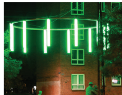
Markering af krydset ved Jørgen Andersensvej med lysinstallation
