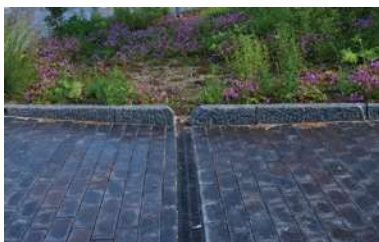
Regnbed – afledning af regnvand
